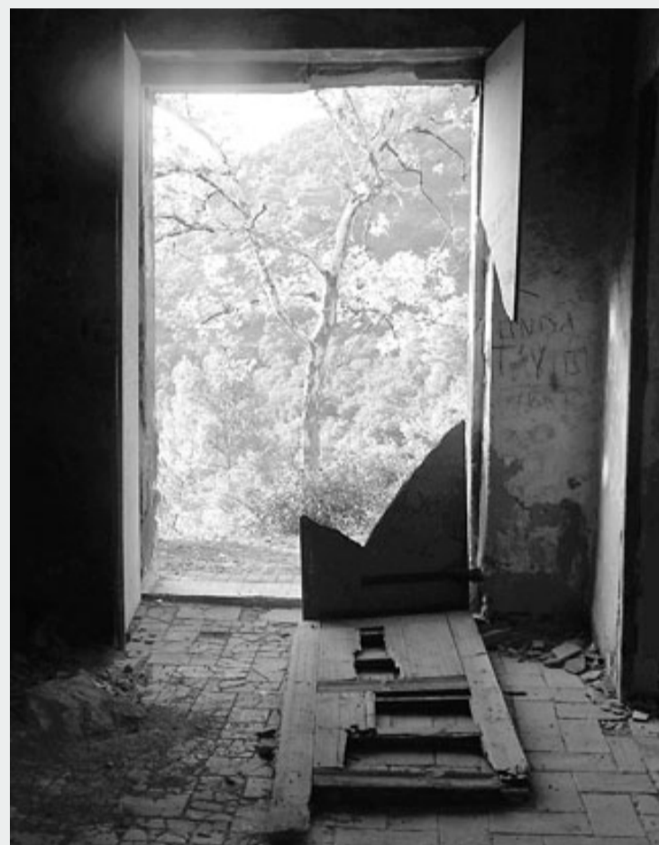
Deterioració. Casa de la Mosquera, a la serra d'Espadà. Al fons, la vall del mateix nom, prop del barranc de la Falaguera. L'abandonament provoca deterioració. / A.H.
