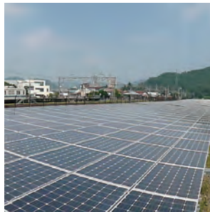
葛生太陽光発電所 (東武エネルギーマネジメント)
