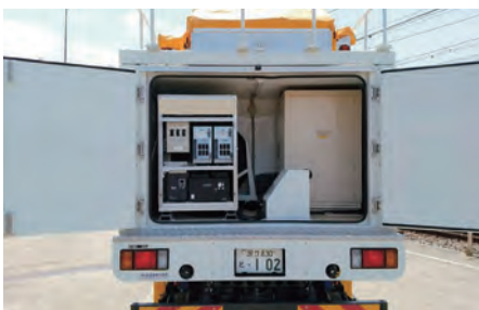
電気検測車に搭載された機器
