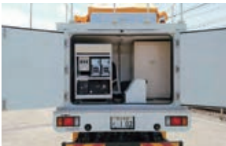
電気検測車に搭載された機器
