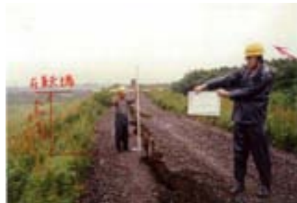
堤防の亀裂・沈下
