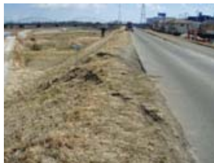
車両による堤防損傷
