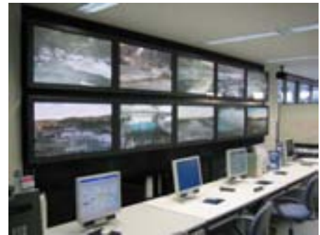
ダム放流設備制御装置
