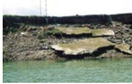
河岸崩壊の状況 名取川 5.0k 付近 (平成 11 年 8 月洪水)
