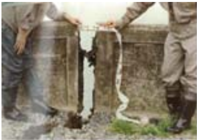
関上特殊堤接合部の開口
