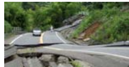
被災状況調査
