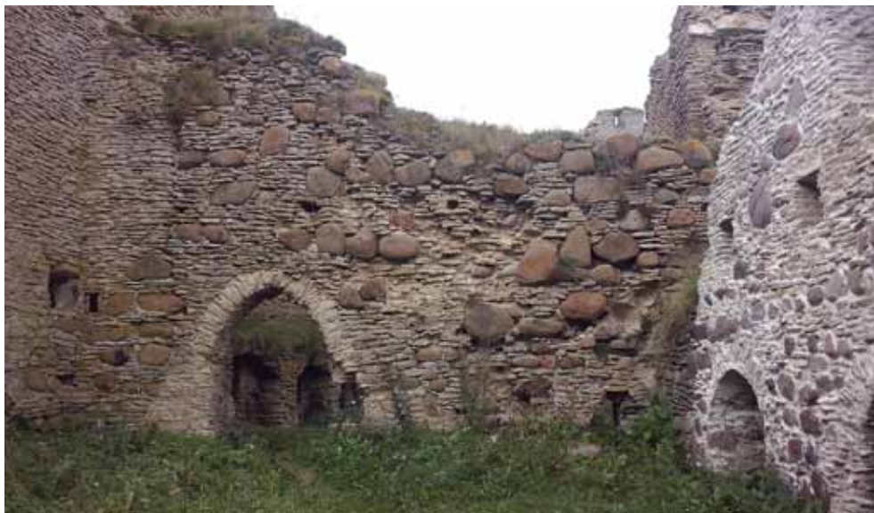
Foto 35. Esimese eeshoovi (2) läänemüüri fassaad enne konserveerimist (Foto: Uno Trumm, 2014).
