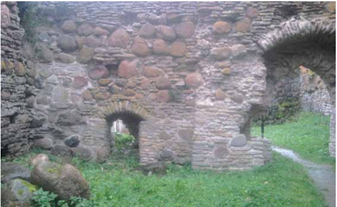
Foto 7. Sisehoovi idaseina alaosa koos laskeava ning väravakannaga on konserveeritud tsementmördiga. 2007. aastal konserveeritud värava ülaosa ja varem konserveeritud väravakanna vahele on ülaosa toetamiseks paigaldatud metallist tugi, mis ühtaegu eraldab ka erineva kontseptsiooni alusel teostatud konserveerimisetappe (Foto: Uno Trumm, 2012).
