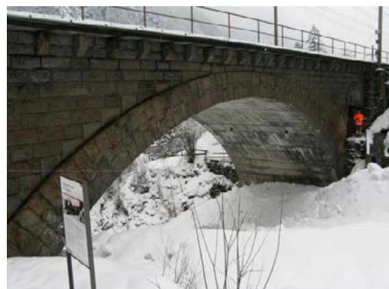
Figure 17: Cordes de décrochage sous le pont. Photo: L. Meier/GEOPRAEVENT
