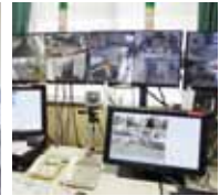
センターの監視モニター
