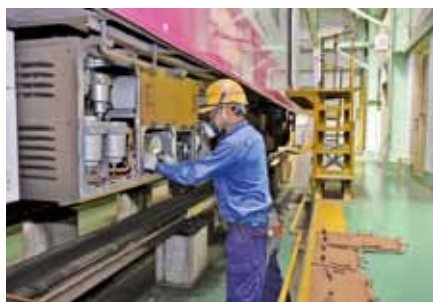
コンプレッサーの点検（月検査）
