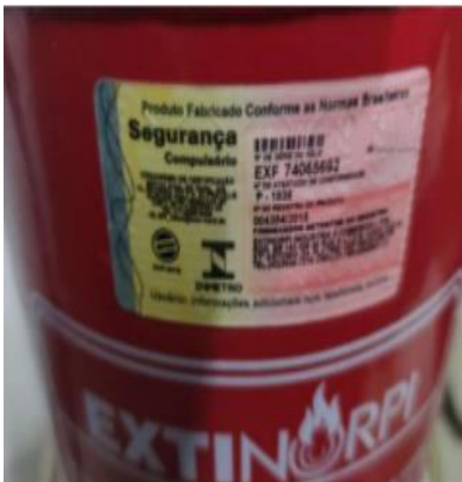
Extintores trancados na sala no CTA Lapa, fora da validade
