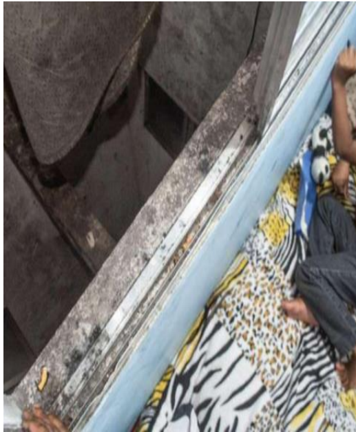
Janela sem tela de proteção no Autonomia em foco I, em detalhe braço de uma criança que se encontrava perto da janela, em cima da cama.
