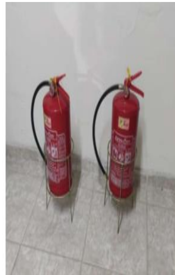
Falta de extintores no CAE Ermelindo Matarazzo
