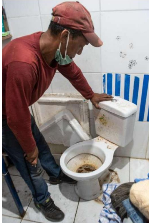
Privada quebrada e entupida no Autonomia em Foco I. Diversos conviventes reclamaram sobre a demora na realização dos reparos.
