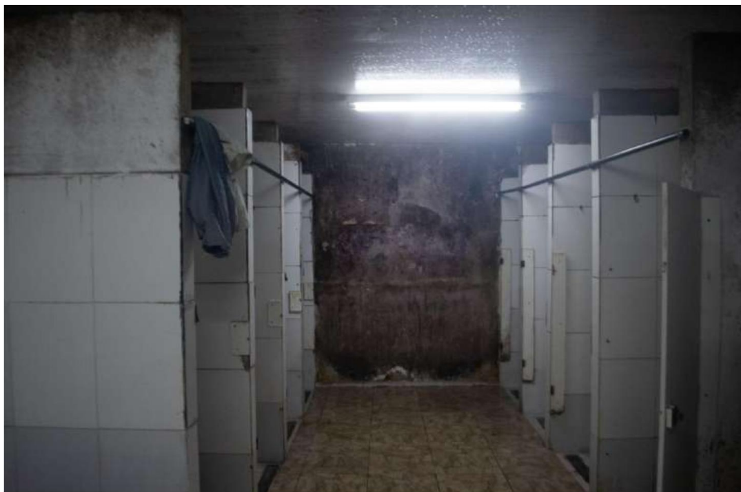
Chuveiros sem porta e paredes tomadas por mofo no CTA LAPA.
