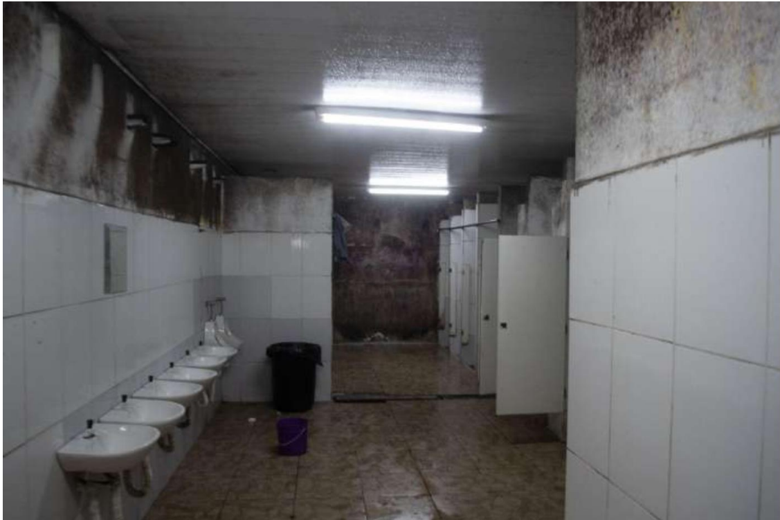
Mofo nas paredes laterais e na parede do fundo do banheiro do CTA LAPA.
