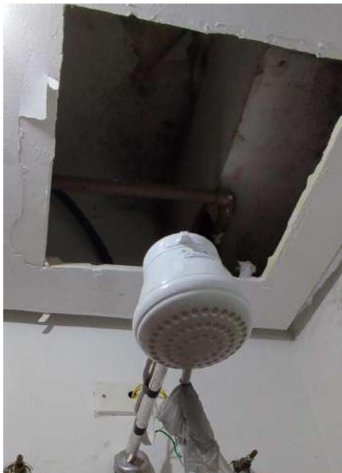
Banheiro sem forro no CAE Art Palácio.
