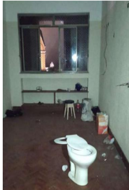
Sexto andar do prédio, desativado e sem uso para os conviventes, mas sem barreiras de acesso
