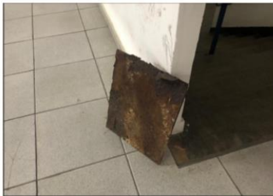
Essa chapa metálica se soltou da cobertura e caiu na área de circulação na entrada do serviço.
