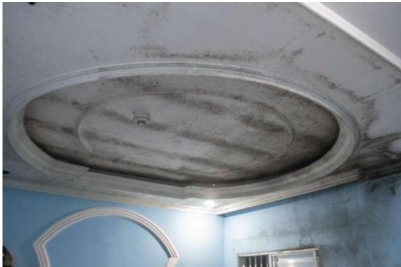
Mofo em um dos quartos do Autonomia em Foco.
