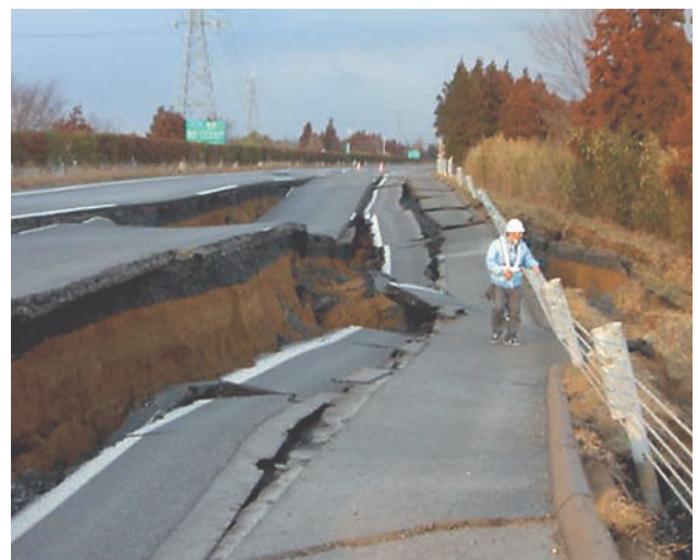
常磐自動車道水戸IC~那珂IC間での路面の陥没と波打ち
