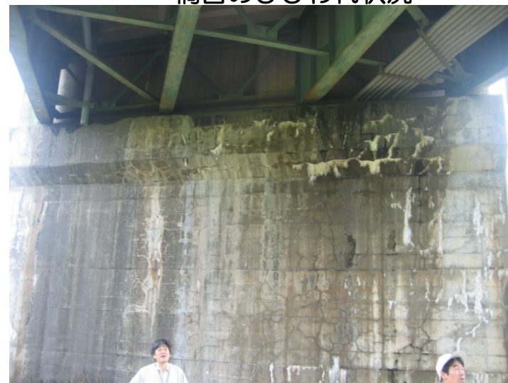
橋台のひびわれ状況
