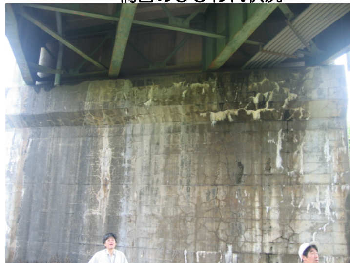
橋台のひびわれ状況
