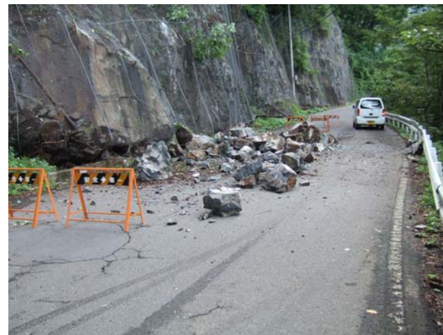
13-14号カーブ H18.9月 落石崩壊
