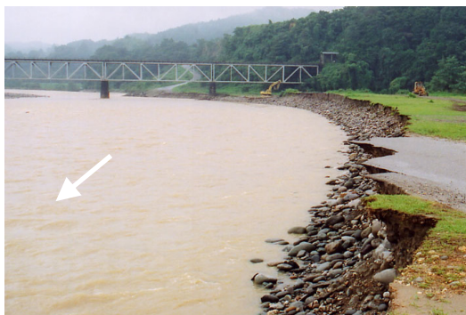
河岸侵食状況 (富山市城生)
