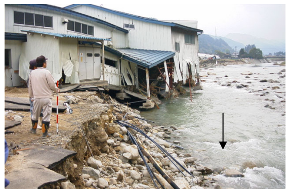
上流部被災状況 (高山市清見町)
