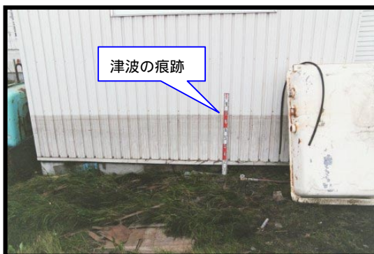
建物に残った痕跡 日時：2003年9月28日撮影 場所：豊頃町大津漁港
