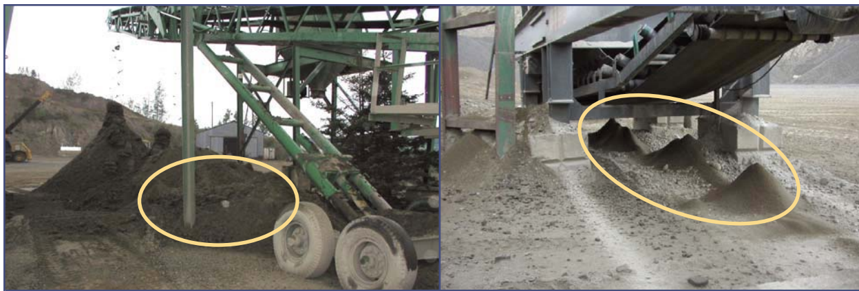
FIGURE 3-21 ACCUMULATION NON DÉSIRÉE DE MATÉRIAUX TRÈS HUMIDES
