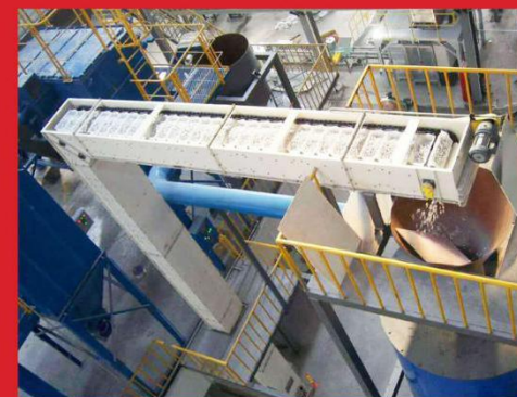
陕西Z型提升机客户现场 Shaanxi Z type hoist customer site
