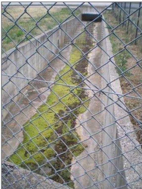
Figura 51 Troço canalizado no aeródromo de Tires
