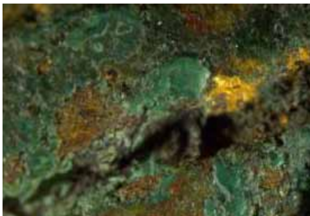
11 - Pormenor de elemento de corrosão de coloração acastanhada, presente em elemento em cobre
