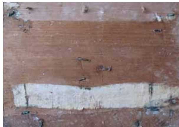
13 - Reforço em papel aplicado sobre fissura existente em pasta de madeira, do foral
