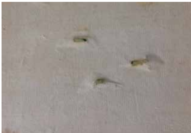
10 - Os elementos de fixação apresentavam-se fragilizados devido à presença de elementos de corrosão, assumindo os mesmos implicações na estabilidade física dos metais
