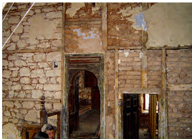
Εικ. 59. Δεσιές και τοιχοποιίες στο αρχοντικό Βούρκα-Κατσικά.
