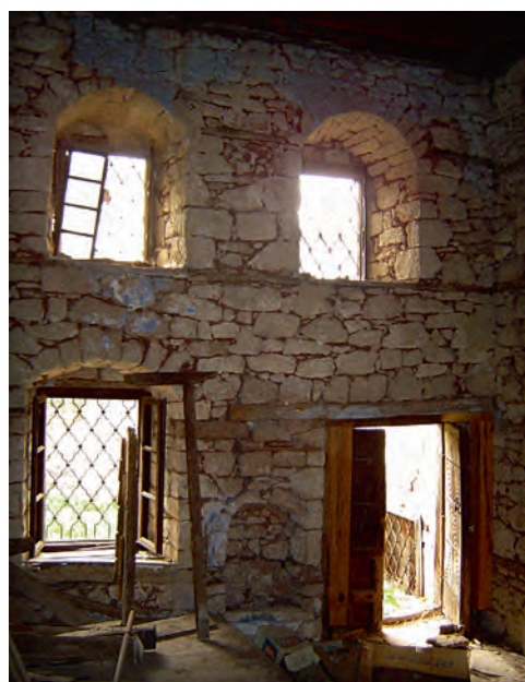
Εικ. 58. Δεσιές και τοιχοποιίες στο αρχοντικό Βούρκα-Κατσικά.
