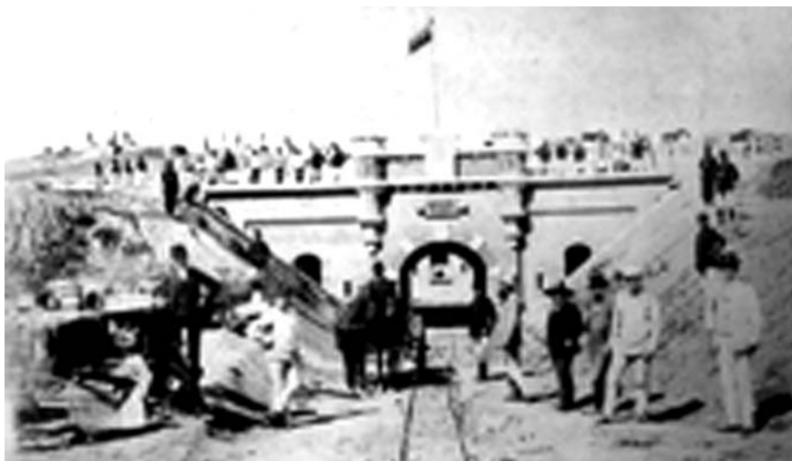
Imagine a fortului nr. 5 Ștefănești aflat în construcție. Reproducere după Cornel și Ioan I. Scafeș, “Cetatea București”, Ed. ALPHA, MDN, 2008.
