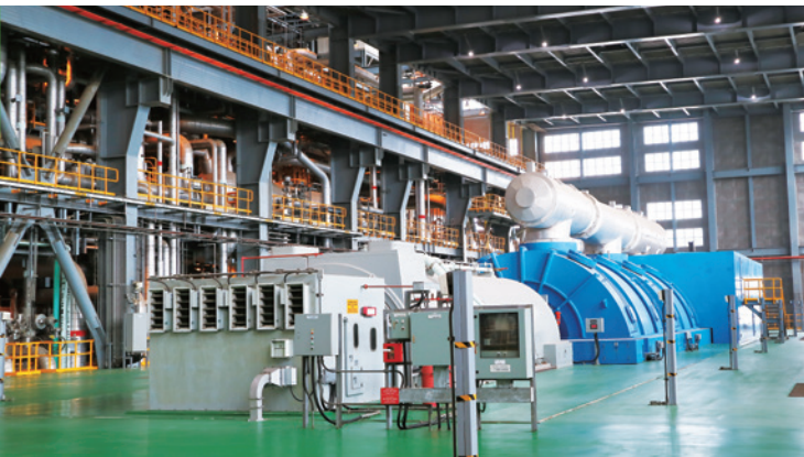
▲ 林口發電廠超超臨界燃煤機組 1 號汽輪機，在最新進的環保技術支持下，空汙防制已接近燃氣發電廠的標準。
