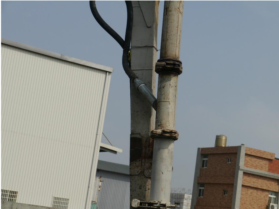
圖 5-1-10 三通管連接水泥漿及底灰管線照片
