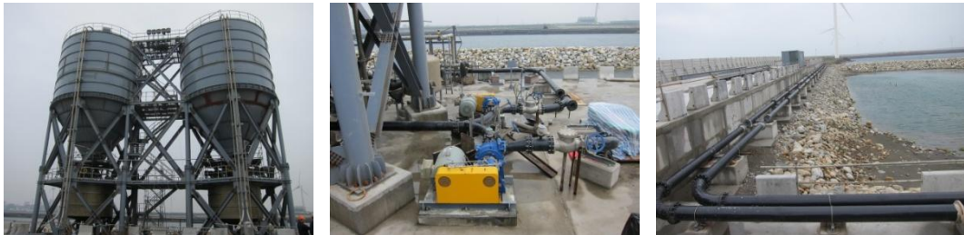
圖 1-1-1 現地灰塘水力排放設備
