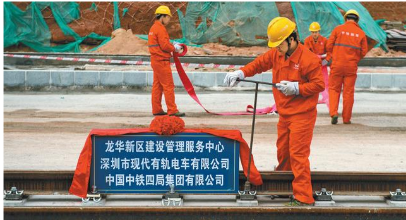
图 5-5 工人为龙华有轨电车示范线工程的最后一节钢轨进行固定
