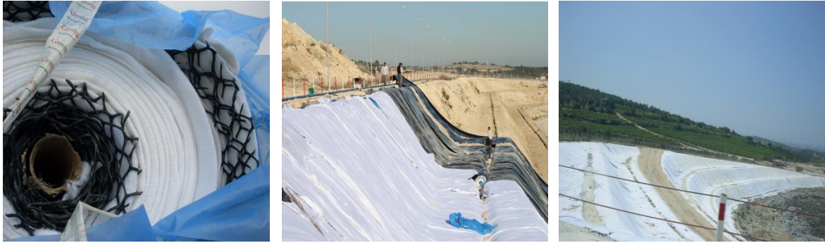
Şekil C.8. Mersin Büyükşehir Belediyesi Düzenli Depolama Alanı 2. Lot Taban Geçirimsizlik Yapısı Olan Geotekstil (M.B.B. Başkanlığı, 2012).
