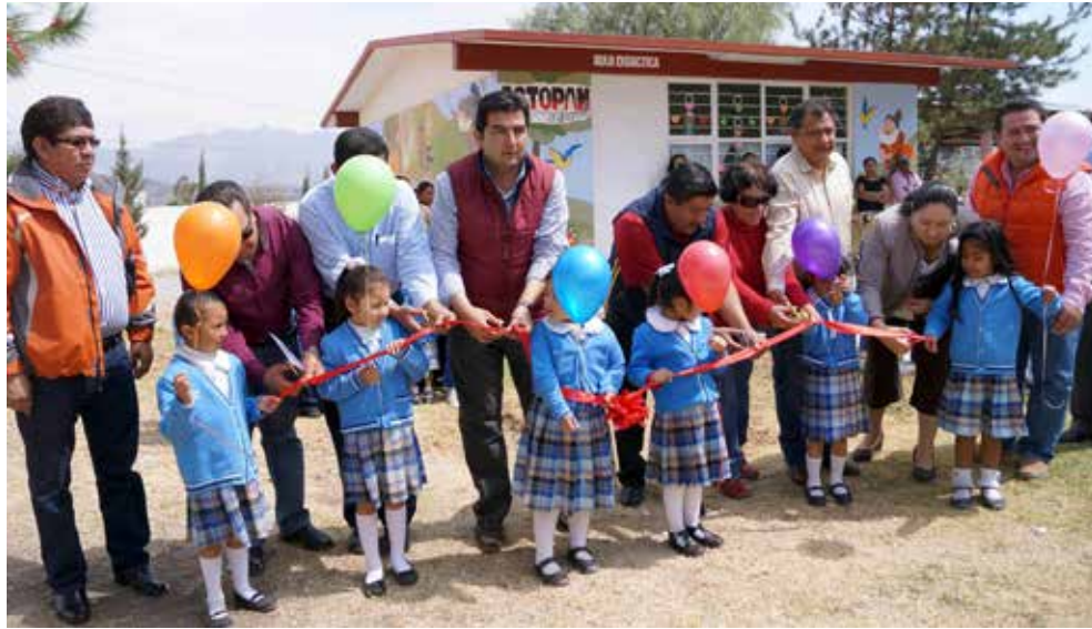
Col. Cuauhtémoc. Construcción de aula tipo INHIFE de 6x8 en preescolar Luis González Obregón (Segunda Etapa).
