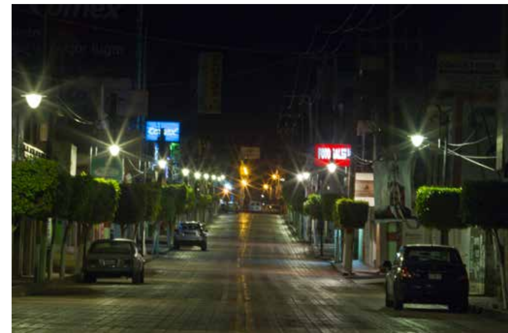
Actopan. Construcción de base hidráulica y alumbrado público en la Calle Zaragoza.
