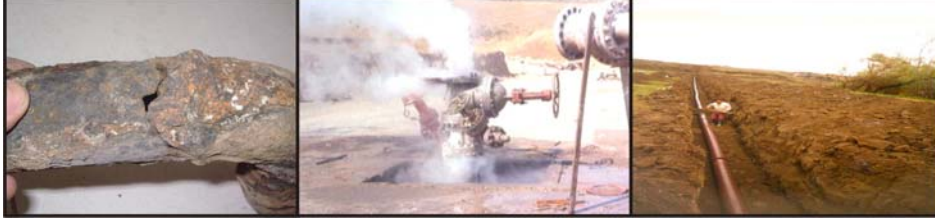
Şekil 6. Jeotermal ısıtma sistemlerinin yapılması sırasında uygun olmayan malzeme kullanımı.
