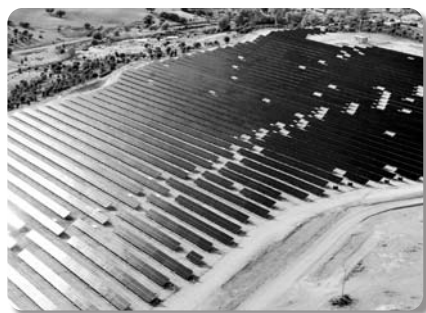
ソーラー発電所(スペイン)
