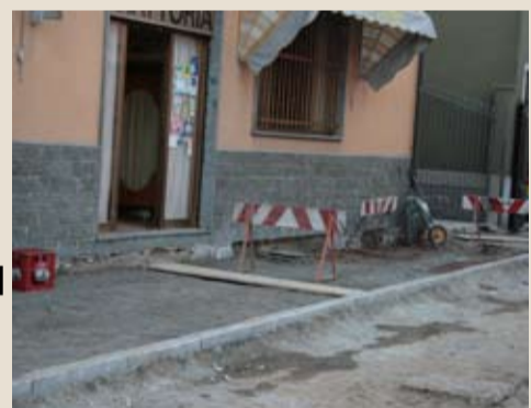
4 agosto 2011 Sistemazione incrocio via Cavour
