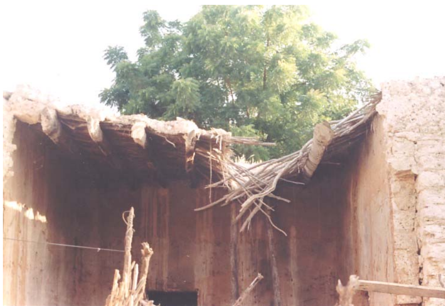
Photo n°4 : Un logement en banco en ruine depuis trois ans
