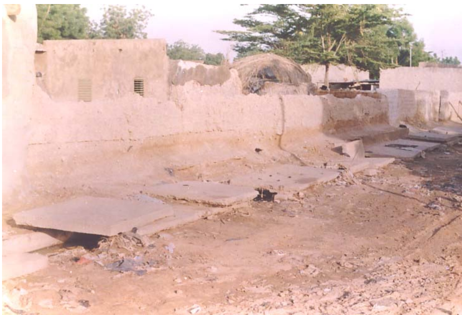
Photo n°3 : Un caniveau mal entretenu dans une rue du quartier Balafon
