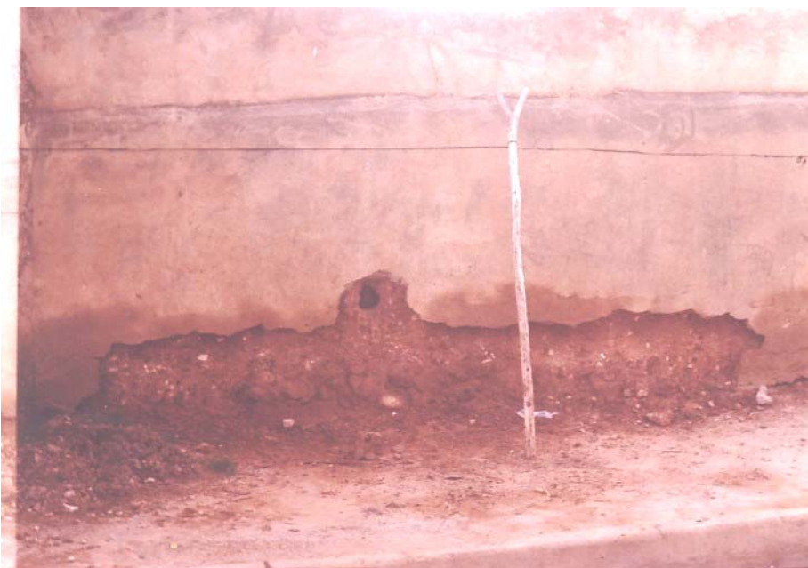
Photo n°5 : Conservation de l'humidité et dégradation du pied d'un mur en semi-dur.
