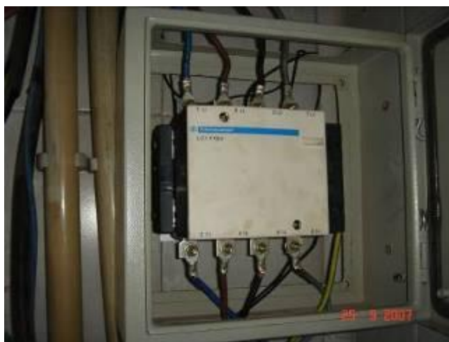
Contactore de potencia para la gestión automática de un horno desde GCE-econectric
