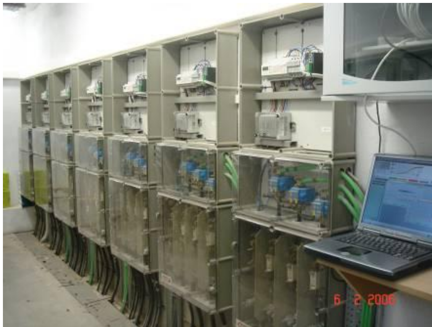
GCE gestionando los consumos eléctricos en las diversas zonas de un edificio: Aviso de incidencias, Contador de energía, Limitador de sobrecargas, ... etc.
