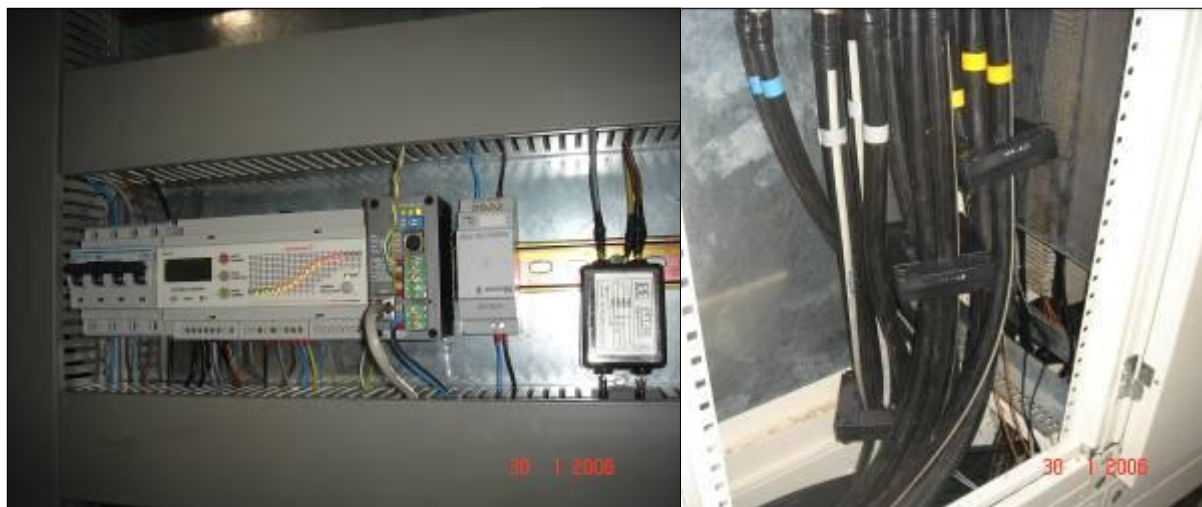
econectric® instalado en cuadro eléctrico con sus trafos de medida en cada una de las 3 fases
