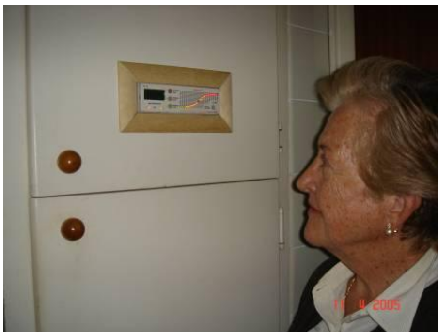
GCE instalado en una vivienda familiar como avisador para evitar olvidos y para gestionar automáticamente desconexiones contra sobrecargas eléctricas.
