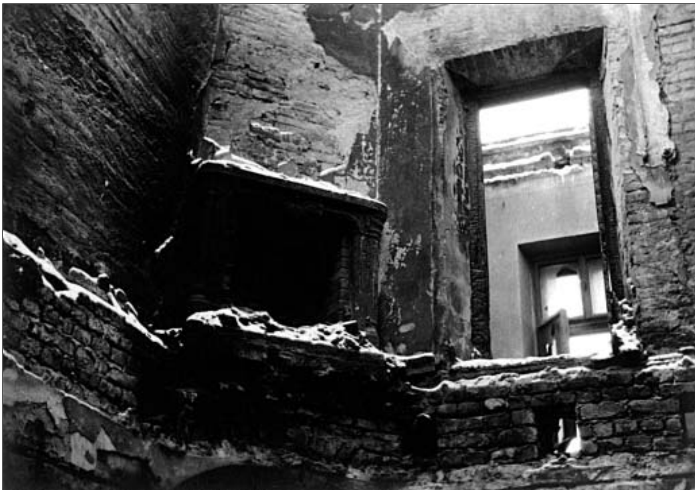
Zawalone stropy pomiędzy parterem i piętrem
