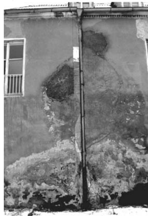
Feuchteschäden an der Fassade (Achse C18) (Feb. 1996)
