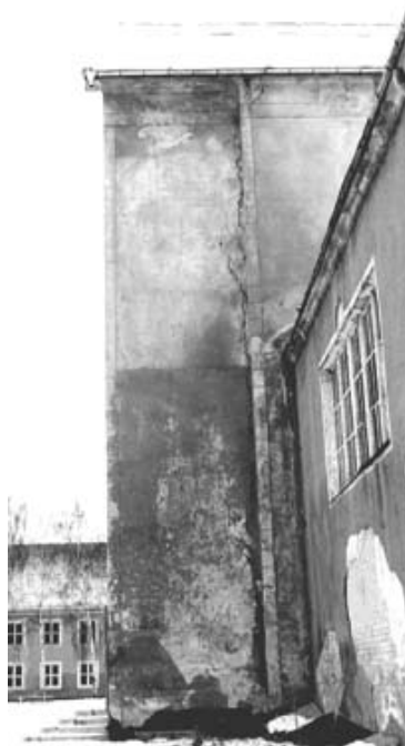
Riß in der Außenwand (Achse M18) (Feb. 1996)
