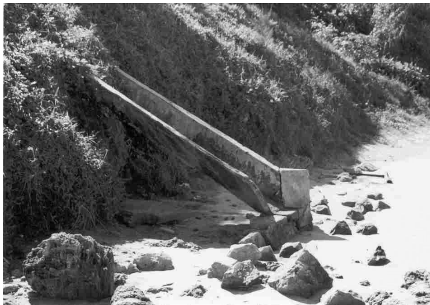
Déversement des eaux usées sur la plage
