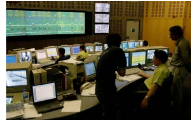
Figure 7 : Operating Control Center - NEL
