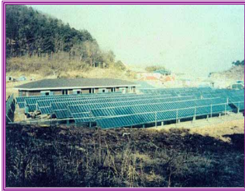
90kW離島用PV系統，韓國Ho-Do島應用於村落 (20戶)之照明、電視、收音機、通訊及抽水用電
