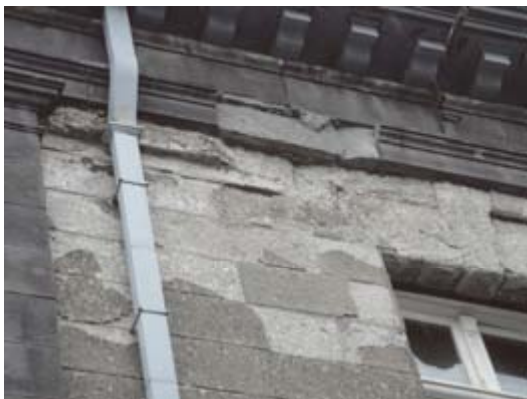
レンガ・石の劣化
