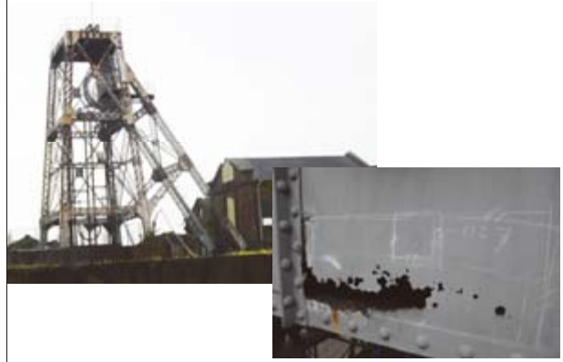
鉄の腐食 三井万田坑竖坑槽
