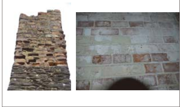
レンガ・石の劣化
