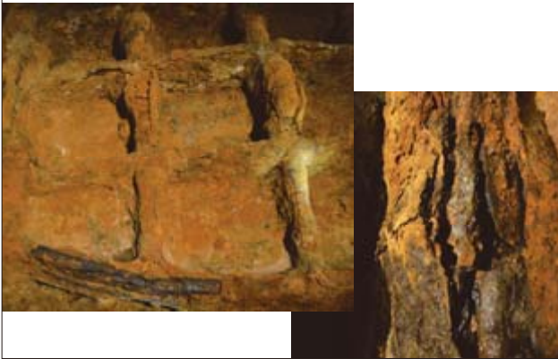
鉄の腐食 三河島水再生場
