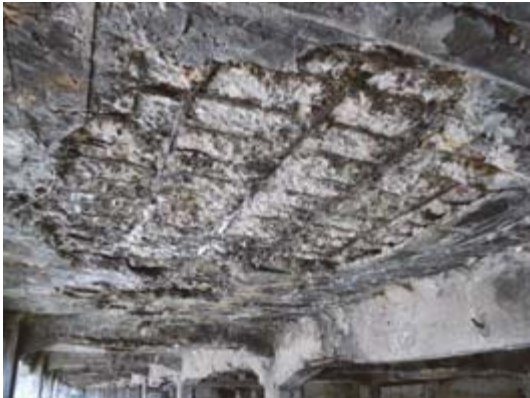
コンクリートの劣化 佐渡:浮遊選鉱場床板裏
