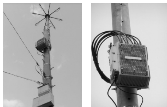
図5.21 WILLCOM PHS基地局 (左：全景、右：送受信装置)
