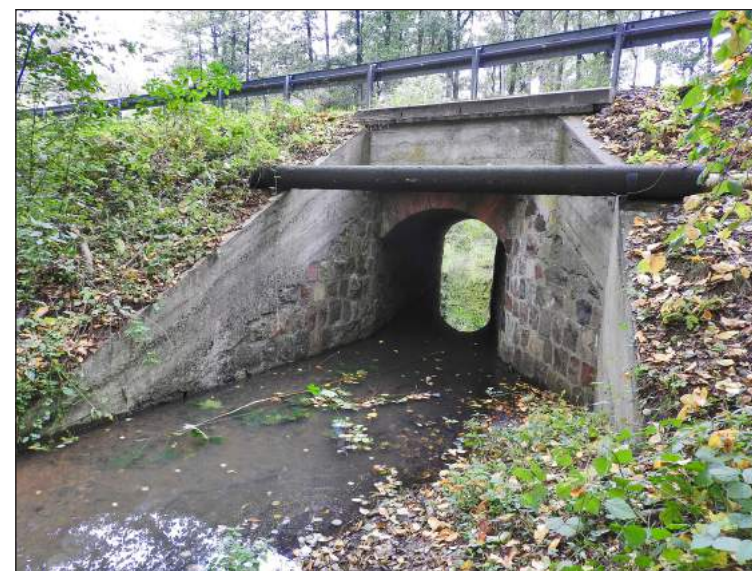
Ryc. 12. Przepust w ciągu al. Wojska Polskiego w Białobrzegach na trasie boczniczy beniaminowski (fot. Autor).
