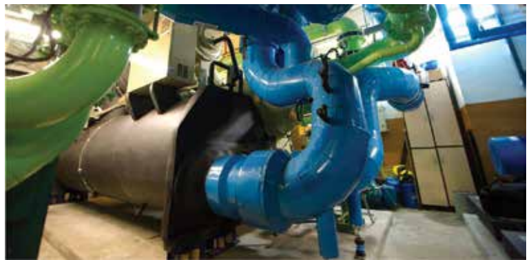
Gambar 38. Instalasi Pipa yang Buruk – Terlalu Banyak Belokan (Presentasi UCWSA)
