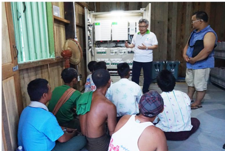
緬甸鄉村照明—在機房辦理操作訓練講習。(106.6.16)
