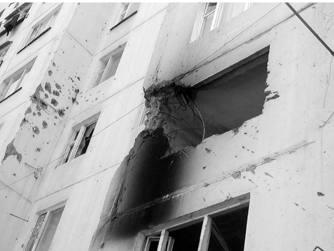
Следы артобстрела на фасаде многоэтажного дома. Район «7-й школы», Грозный, Чечня, 2004
