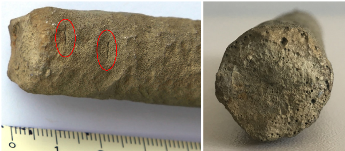
Abbildung 4: Oberfläche (links) und Querschnitt (rechts) des korrodierten Bereichs einer Bewehrungsprobe nach dem Beizen
