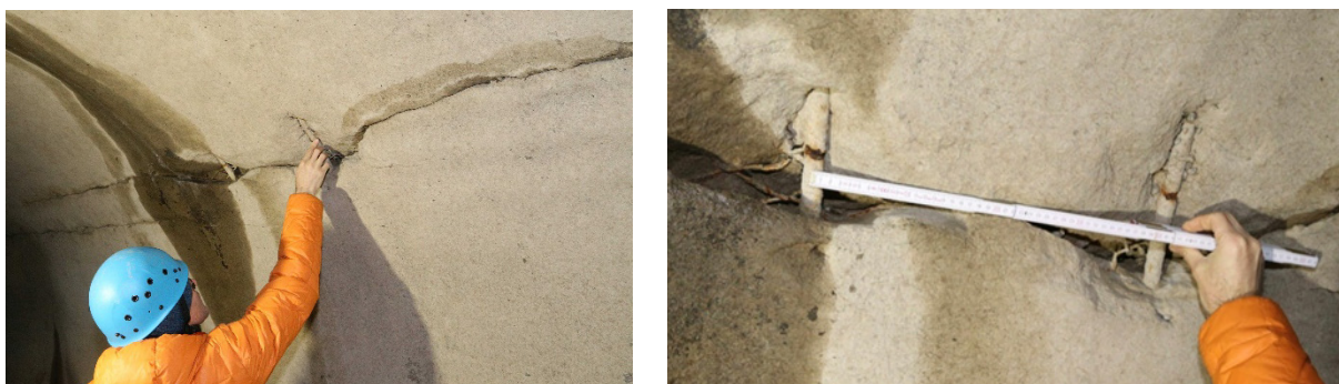
Abbildung 3: Durchtrennte Bewehrung im Riss im östlichen Umlaufkanal der Westkammer (links), Nahaufnahme (rechts)
