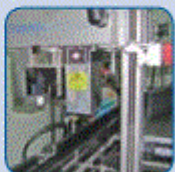
Διάταξη με κλειστή πηγή Am-241 για τη μέτρηση στάθμης υγρού
