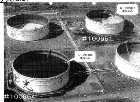
出光興産 大型原油タンクの油面露出状況 （写真No.5）
