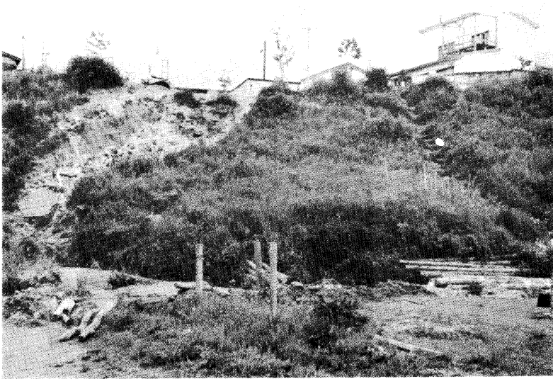
写真4 盛土被害(釧路)
