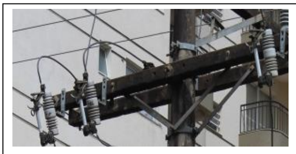
FOTO 128: CHAVE FUSÍVEL EM BOAS CONDIÇÕES DE INSTALAÇÃO Torre de Iluminação 1 e 2
