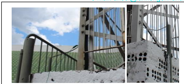
FOTOS 250 E 251: ATERRAMENTO - TORRE 4
