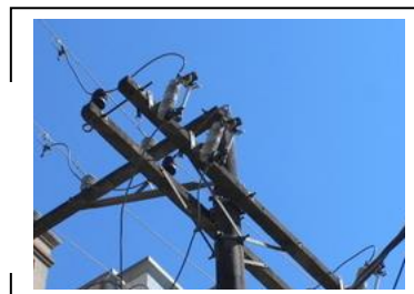
FOTO 129: PARA RAIOS POLIMÉRICOS EM BOAS CONDIÇÕES. Torre de Iluminação 1 e 2
