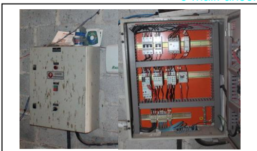
FOTOS 158 E 159: QUADRO DE COMANDO – BOMBA DE IRRIGAÇÃO
