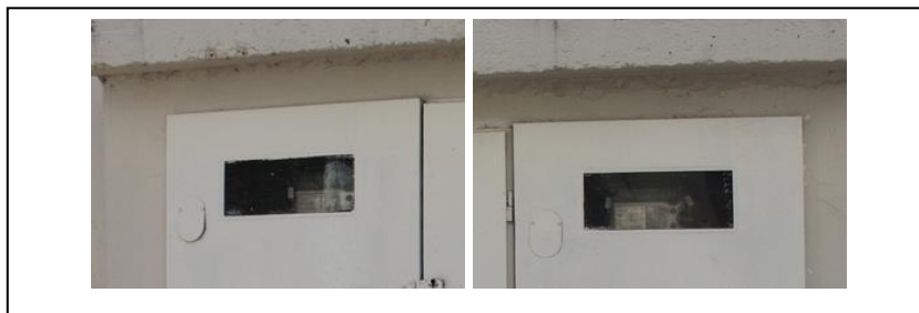
FOTOS 141 E 142: MEDIDOR DE ENERGIA EM BOAS CONDIÇÕES Quadro de Medição Entrada 2 – Alojamentos
