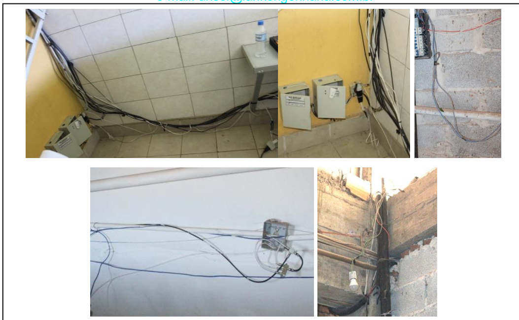
FOTOS 188 A 192: ALIMENTAÇÃO ELÉTRICA - ESTÁDIO
