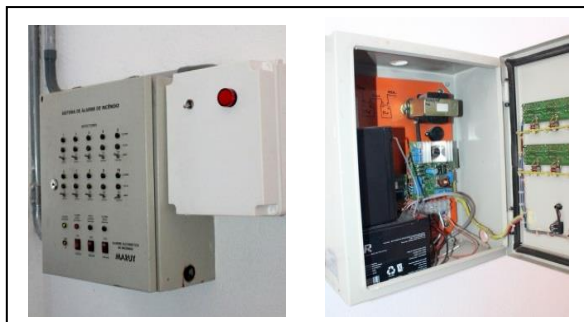
FOTOS 272 E 273: QUADRO DE CENTRAL DE INCÊNDIO
