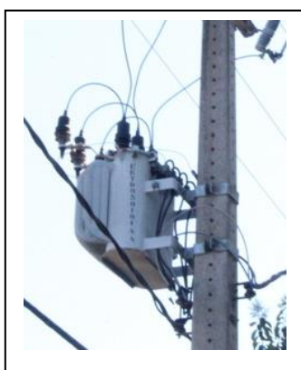
FOTOS 110: CRUZETAS EM BOAS CONDIÇÕES DE INSTALAÇÃO Alojamento Profissional
