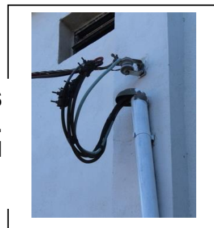
FOTO 124: ENTRADA DOS CABOS SUBTERRÂNEOS. Restaurante e Vestiário Local
