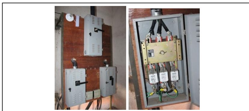
FOTOS 147 E 148: PROTEÇÃO DA TORRE Quadro de Acionamento – Torre de Iluminação 1 e 2
