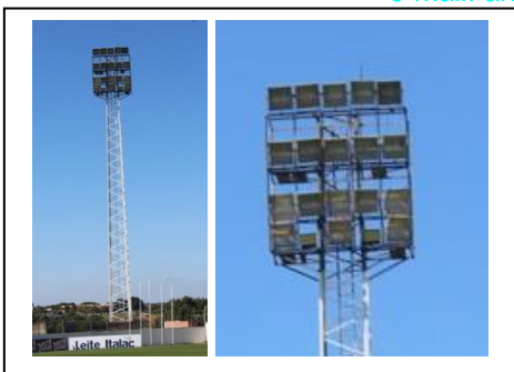
FOTOS 234 E 235: ILUMINAÇÃO TORRE 3
