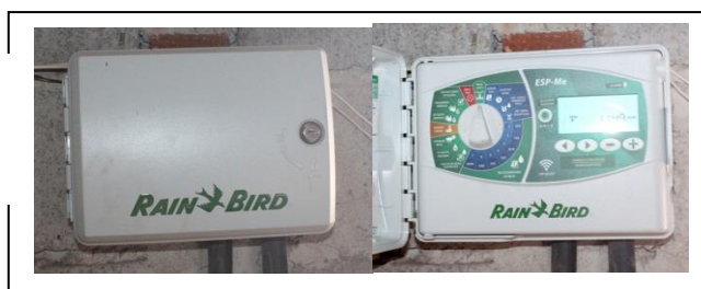
FOTOS 160 E 161: QUADRO TEMPORIZADOR DE IRRIGAÇÃO
