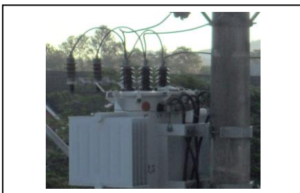
FOTO 103: ISOLADORES APARENTEMENTE EM BOAS CONDIÇÕES. Administração e Torre 3-4
