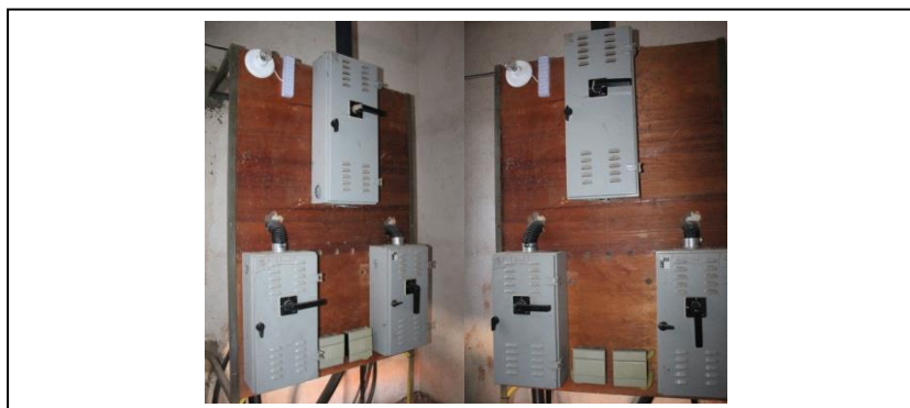
FOTOS 137 E 138: PROTEÇÃO DA TORRE Torre de Iluminação 3 e 4
