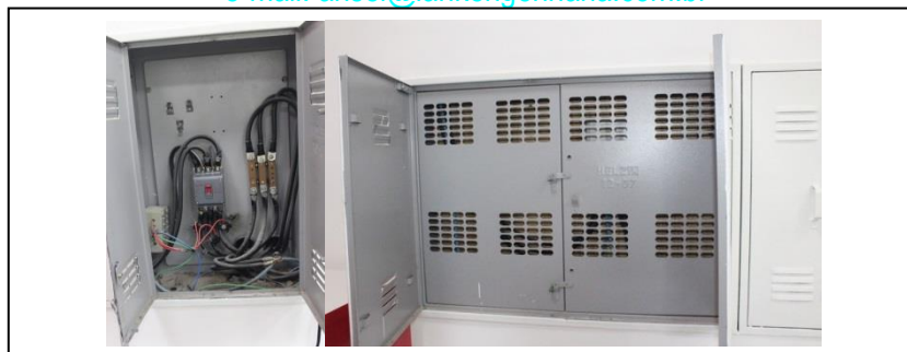
FOTOS 145 E 146: MEDIDOR DE ENERGIA EM BOAS CONDIÇÕES Quadro de Medição Entrada 3 – Restaurante e Vestiário Local
