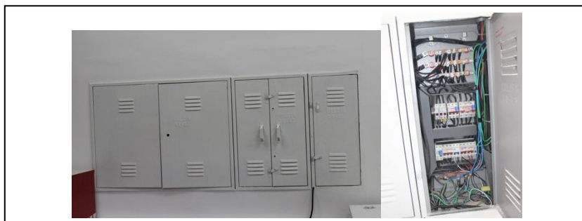
FOTOS 143 E 144: ESTRUTURA EM BOAS CONDIÇÕES Quadro de Medição Entrada 3 – Restaurante e Vestiário Local
