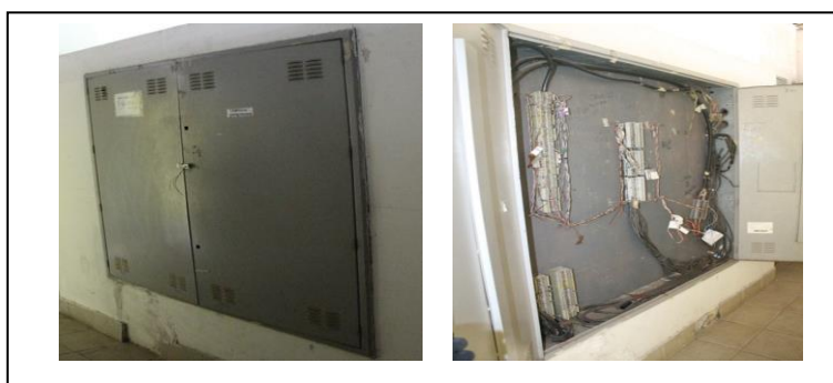
FOTOS 270 E 271: DG – TELEFONIA CABINE DE IMPRENSA
