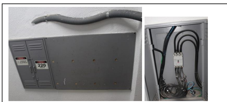
FOTOS 135 E 136: MEDIDOR DE ENERGIA EM BOAS CONDIÇÕES Entrada 1 – Torre de Iluminação 3 e 4
