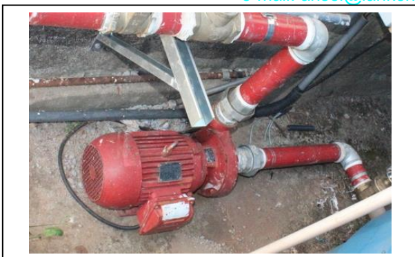
FOTO 195: BOMBA DE COMBATE A INCÊNDIO.
