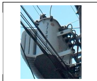
FOTOS 119: CRUZETAS EM BOAS CONDIÇÕES DE INSTALAÇÃO Restaurante e Vestiário Local
