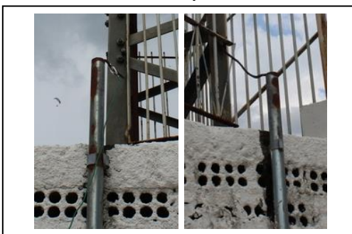
FOTOS 244 E 245: ATERRAMENTO - TORRE 1
