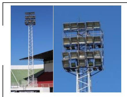
FOTOS 236 E 237: ILUMINAÇÃO TORRE 4
