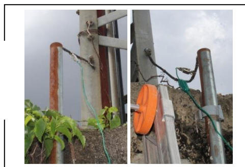
FOTOS 246 E 247: ATERRAMENTO - TORRE 2
