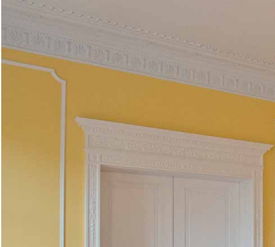
Gelber Saal im Erdgeschoss während der Bauarbeiten und nach der Fertigstellung Yellow Room, First Floor, details, in-progress and complete
