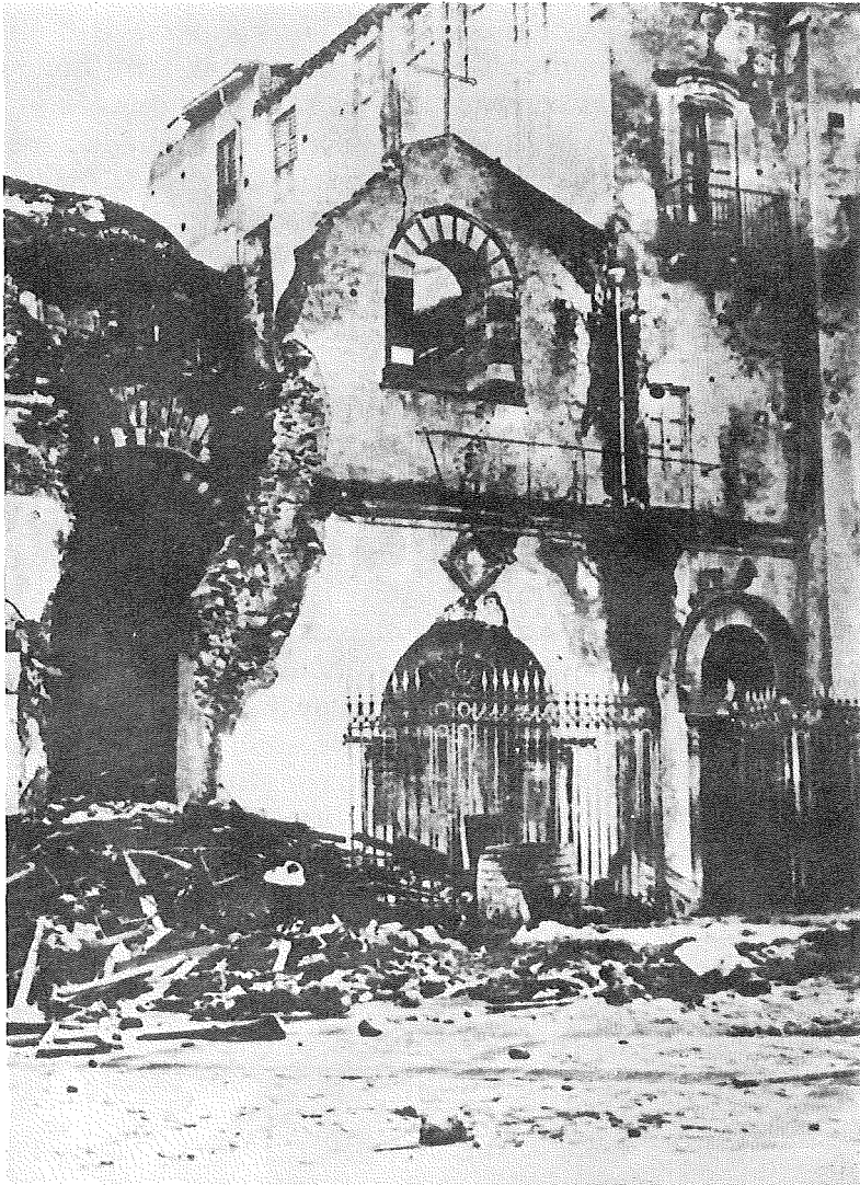
Fig. n. 3 - La facciata principale dopo il terremoto del 1908. Si notano i danni della chiesa e le costruzioni incombenti sul lato meridionale.
