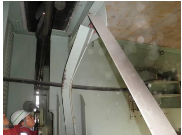
対傾構の座屈
