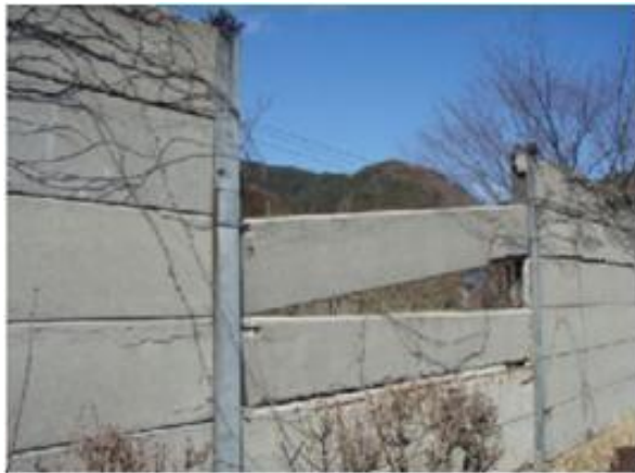
東北自動車道 福島飯坂IC～国見IC 下り線 278kp 遮音壁の脱落
