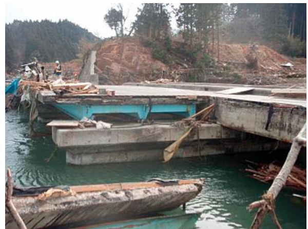
国道 45 号 南三陸町 水尻橋
