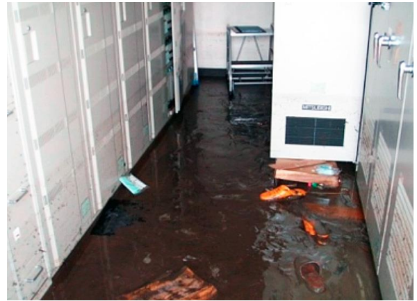
仙台港北 IC 通信機械室浸水状況
