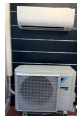
Figur 2: Värmepump med en utomhusenhet (nedtill) och en inomhusenhet (upptill).
