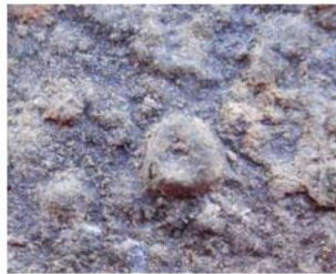
Fig. 4. Formațiuni din crusta de coroziune de tip rotunde
