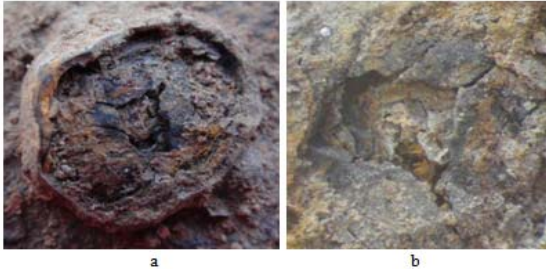
Fig. 5. Formațiune distrusă din crusta de coroziune a – imagine generală; b – detaliu pentru fisuri
