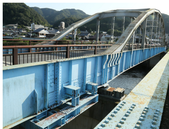
方谷橋 昭和12年竣工 下路カンチレバーランガー 西側のプレートガーダーは昭和47年に架け替えられ、また東側は国道幅員による河川埋立てによって竣工当時より短くなっている。
